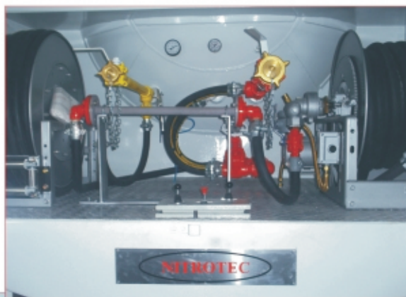
Enxoval de válvulas
