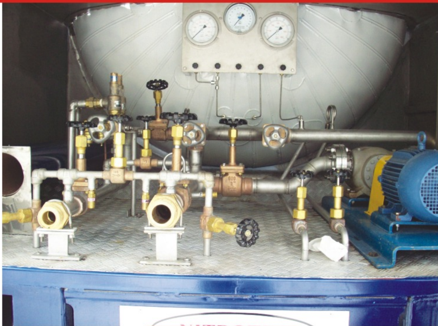
Plumbing caminhão tanque CO 2
