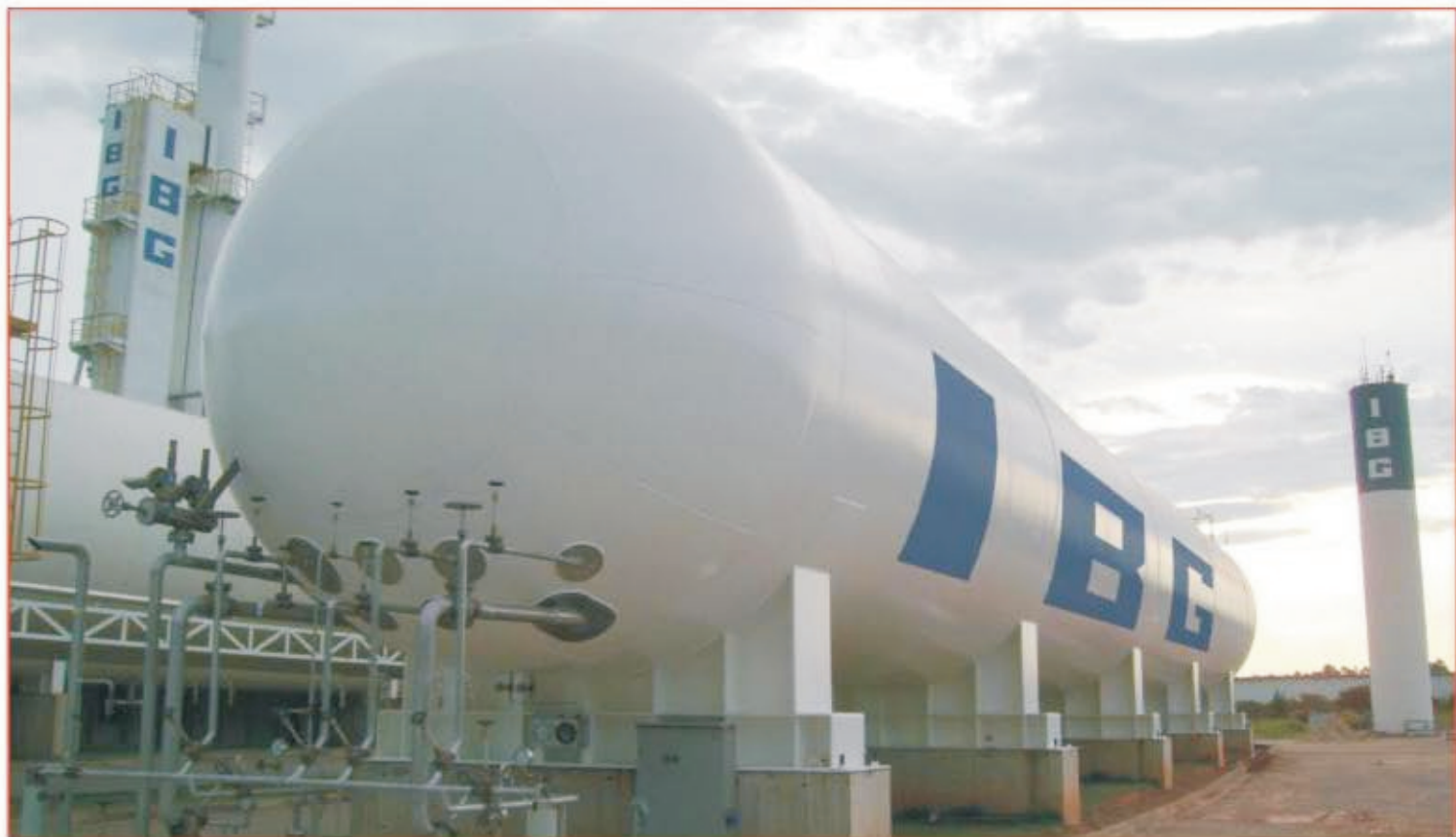
Tanque criogênico horizontal de 600.000 litros isolado a vácuo
