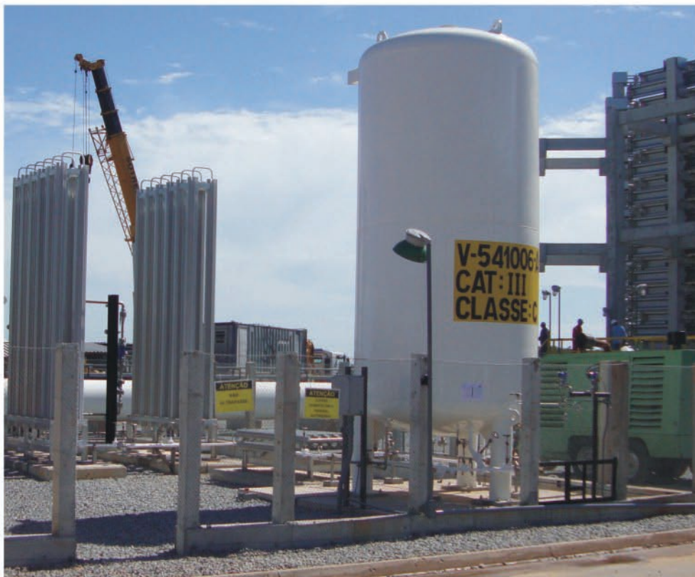
Ground Flare é fundamental para a segurança do Terminal de Cabiúnas
