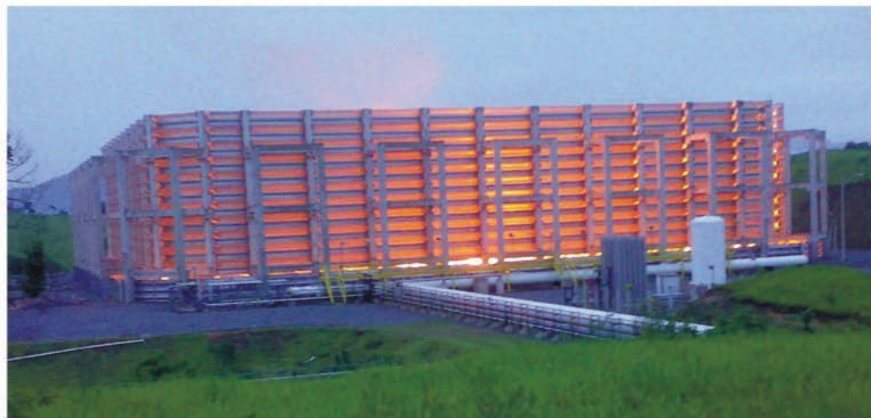
Ground Flare em operação assistida
