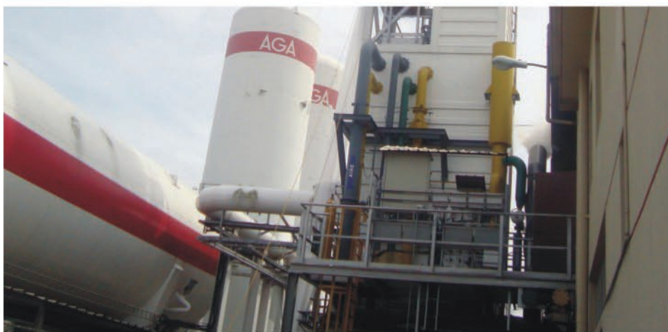
Planta de gases do ar do grupo Linde no Equador
